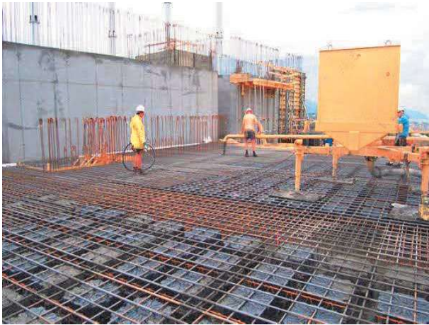
Şek.3 Döşeme betonunun dökülmesi
